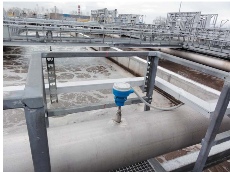
Рис.2. ТЕРМАЛЬНО-МАССОВЫЙ РАСХОДОМЕР НА ПОДВОДЯЩЕМ ТРУБОПРОВОДЕ
